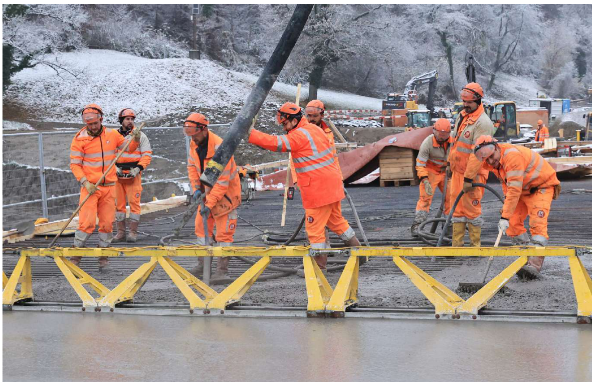
Bei fast jedem Wetter auf der Baustelle: Im Bauhauptgewerbe ist bis 2040 jede sechste Stelle nicht besetzt. Foto: Archiv/Viktor Zimmermann
